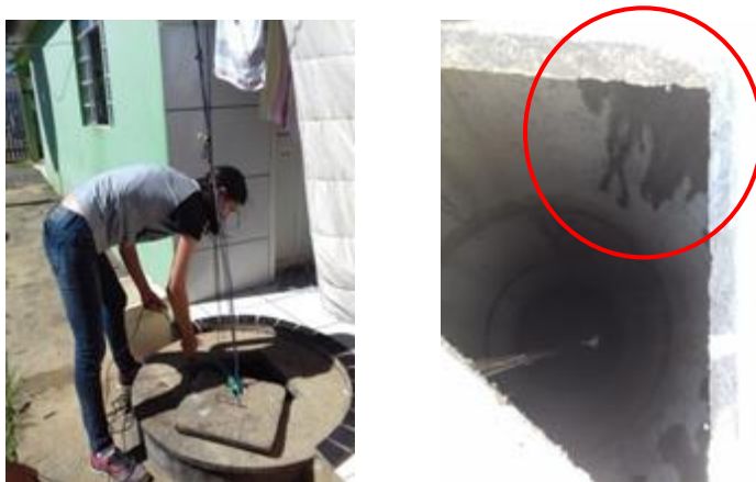
Figura 13- Imagens do poço 2 em Presidente Médici, tampa e revestimento interno.
