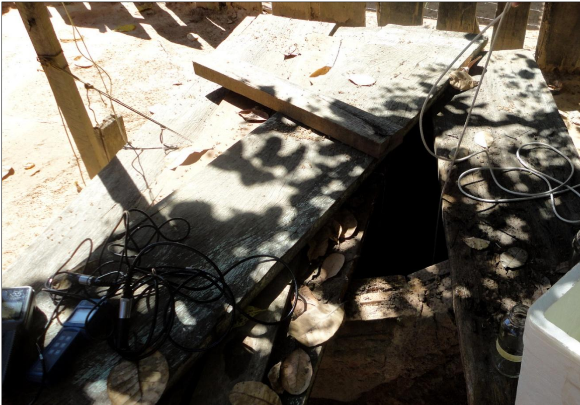
Figura 2 - Poço em condições inadequadas em decorrência da ausência de tampa de concreto para vedação e manilhas (bairro Boa Esperança).
