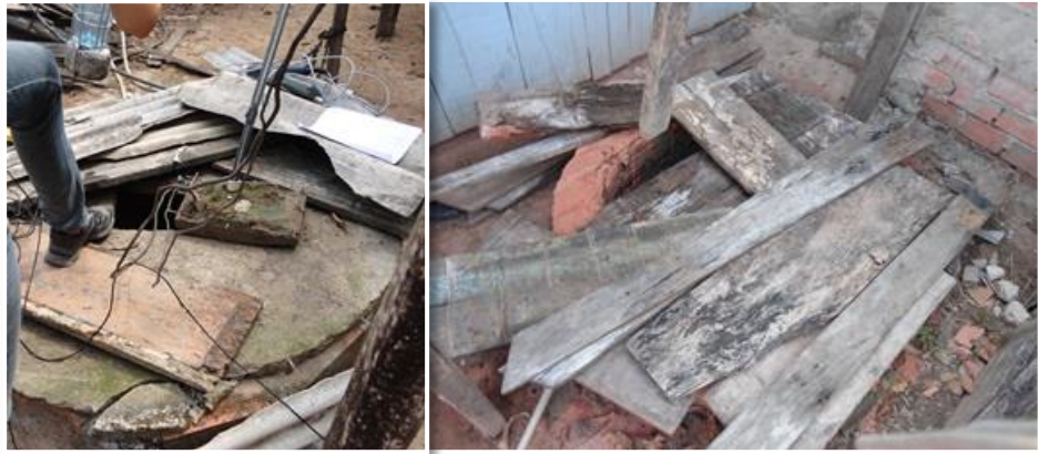
Figura 13 – Condições impróprias de vedação. Bairro Boa Esperança, Ji-Paraná, RO, 2013. Fonte: Os organizadores.
