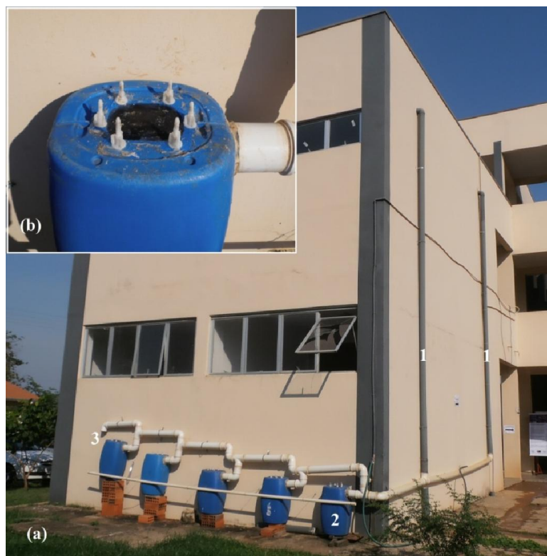
Figura 6 – (a) Sistema de coletores instalados para armazenamento da água da chuva proveniente do telhado. (1) Canalização de transporte da precipitação do telhado para os coletores; (2) Coletores da precipitação; (3) Saída da água sobressalente. (b) Abertura superior dos coletores para retirada das amostras.
