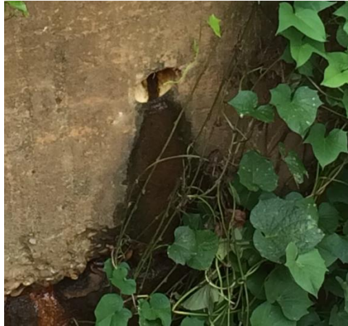
Figura 16 - Despejo clandestino de efluente no curso do córrego Ouro Preto. Fonte: Autor
