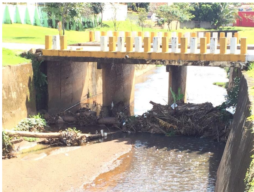
Figura 17 - Resíduos sólidos acumulados a jusante do ponto 02. Abril de 2017. Fonte: Autor.
