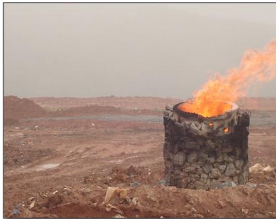
Figura 3. Flare aberto realizando a queima de biogás.
