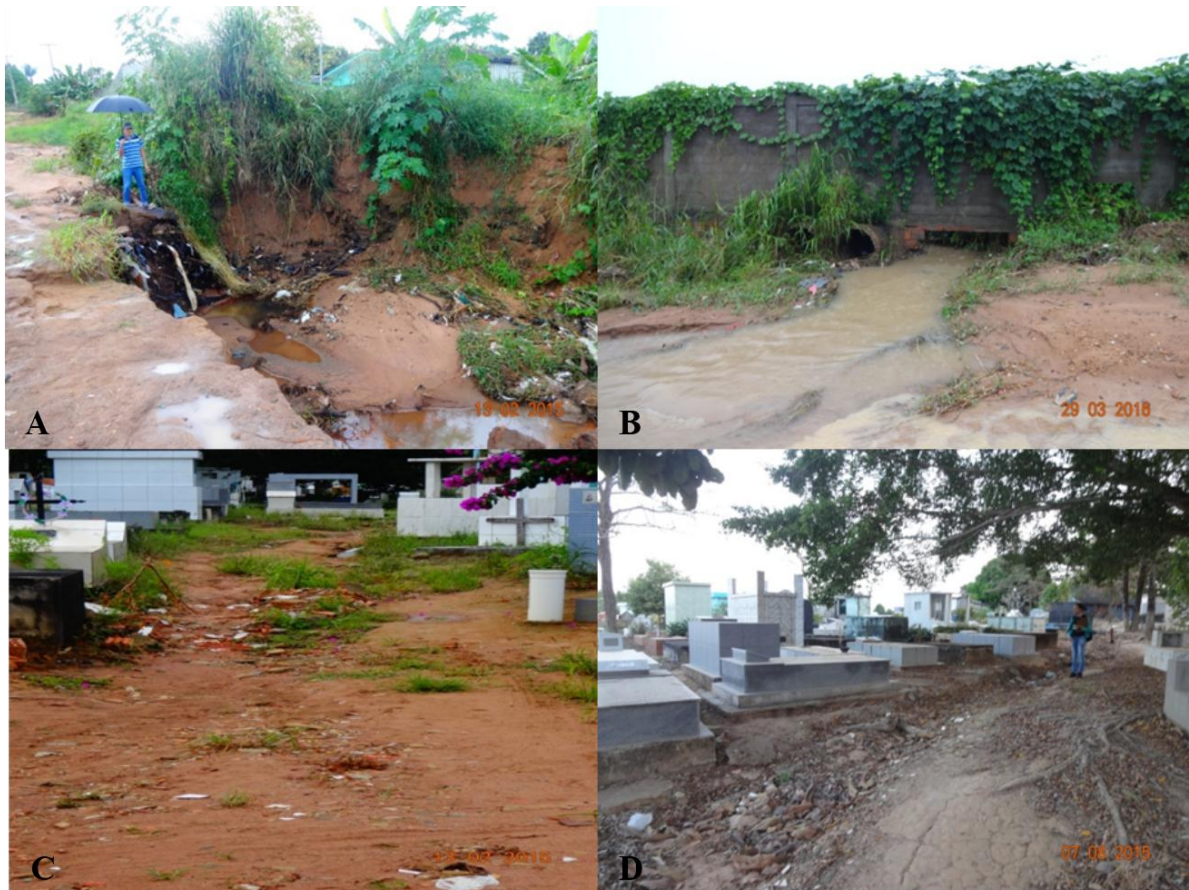
Figura 10 – Voçorocas (A) e ravinas (B, C e D) causadas pela ausência do sistema de drenagem no interior e no entorno do Cemitério da Saudade.
